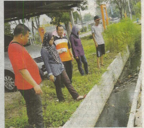
Sebahagian penduduk melihat keadaan sistem perparitan yang perlu diberi perhatian di Taman Permai.
